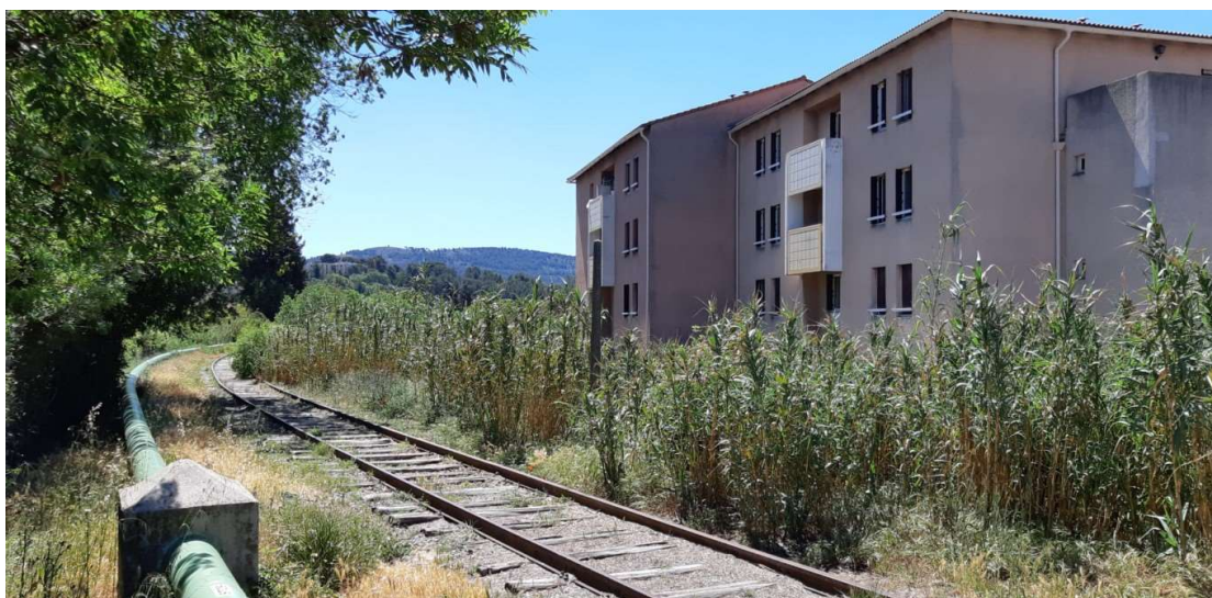
Vue de la canalisation ALTEO, le long de la voie au niveau de la campagne Valérie
